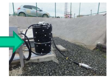
1F排水路集水枡に設置したPSF
